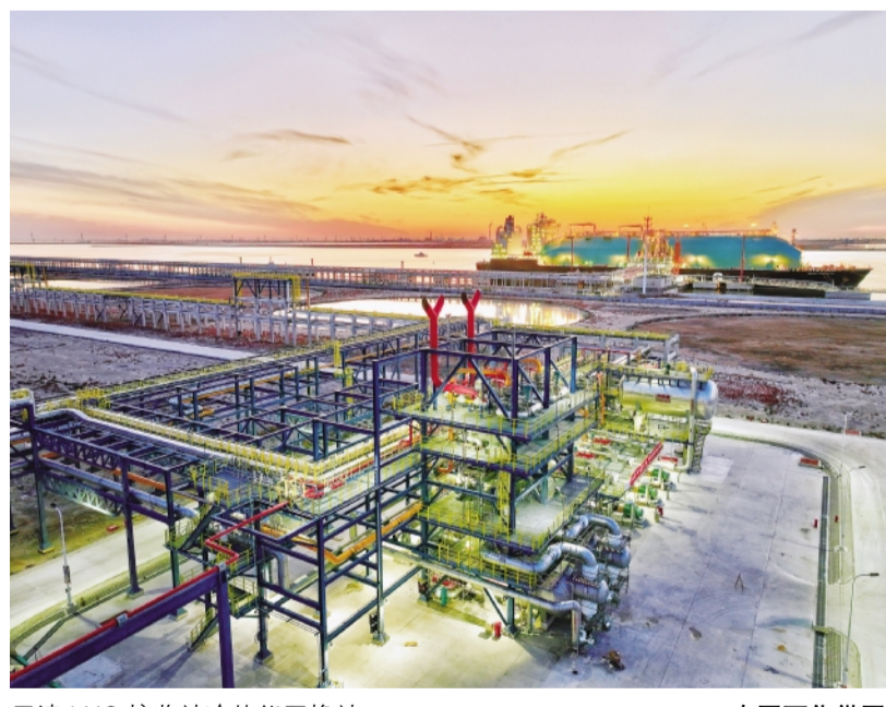
天津 LNG 接收站冷热能互换站。中国石化供图
